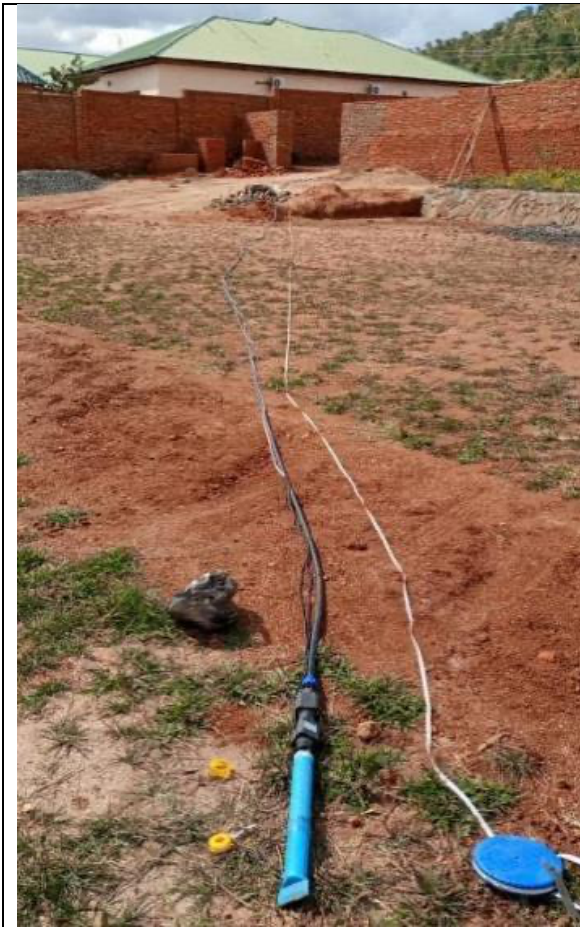
Instalación de 2 bombas modelo ZL 50-20N
