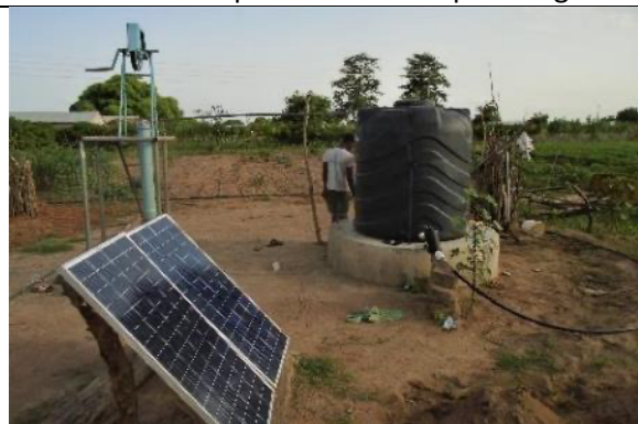
1 bomba ZL 50-20N está reemplazando a una bomba de mecate. Se bombea a un tanque y se utiliza para el riego por goteo.
